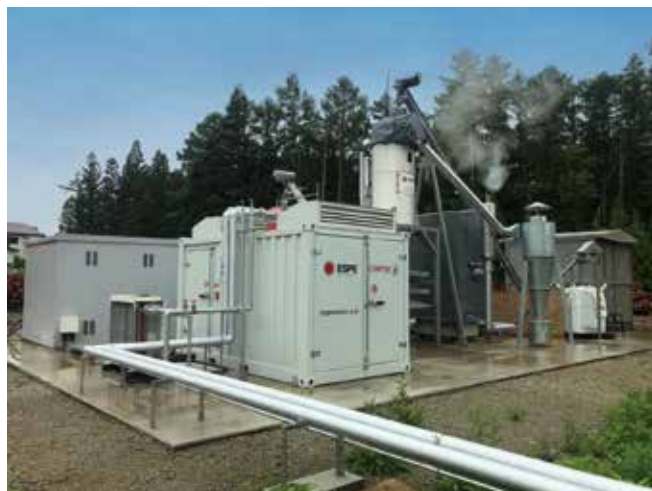
木材チップ製造業者の敷地内に設置した小型バイオマス発電機。発電に付随して発生する排熱をチップ乾燥に供給できる
