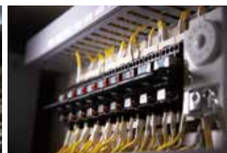
各種制御盤の設計・製作
